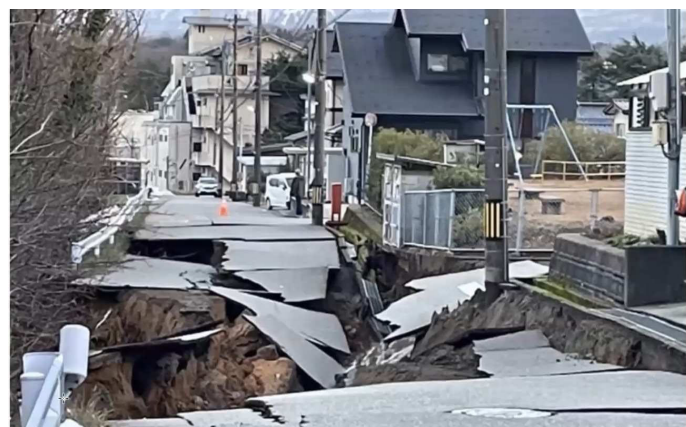
図2 小松市の道路に見られた被害
